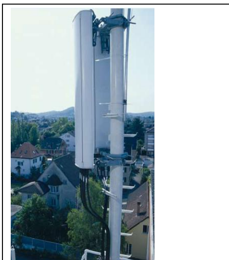
基地局に設置されたアンテナは、その到達範囲内の携帯電話とのやりとりを可能にする
